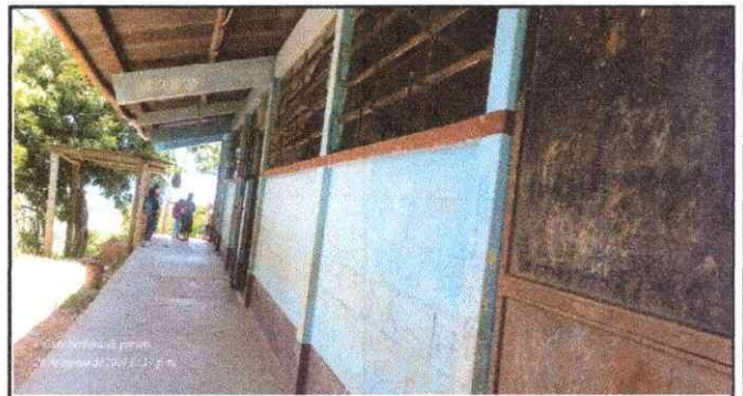
Foto 4: Se observa el desgaste de canales en el modulo 1
